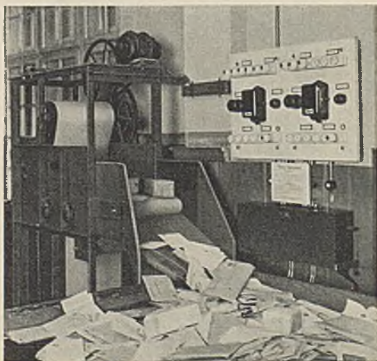
Endstelle einer Briefkastenleerungs-Anlage mit Bandaufzug.
