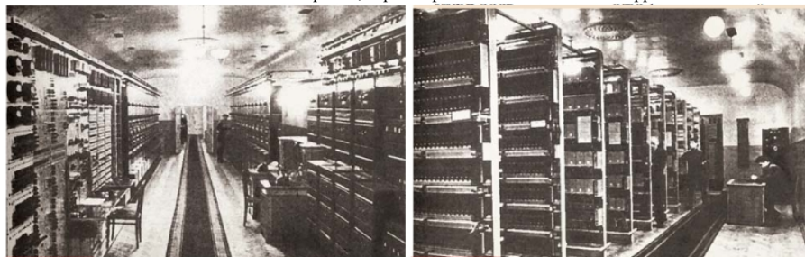
1944 Station de communication V de Moscou. Hall de l'ATC interurbain.
