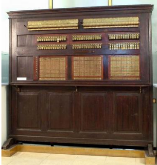
Standard à 78 lignes. A cette date les opérateurs (trices) se tenaient debout devant le meuble.
