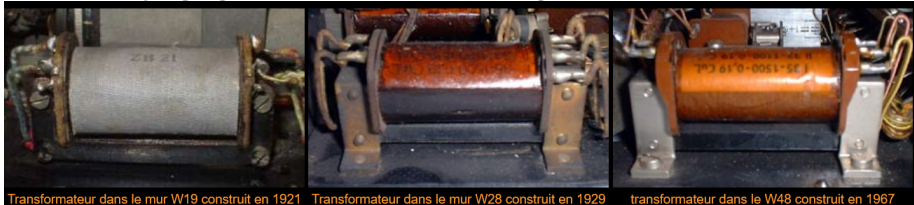
Transformateur dans le mur W19 construit en 1921 Transformateur dans le mur W28 construit en 1929 transformateur dans le W48 construit en 1967
